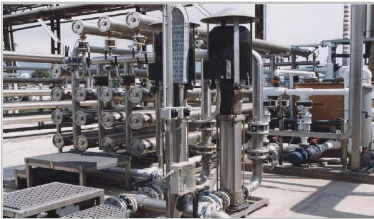
Figura 43. impianto di osmosi inversa Nuova Solmine
